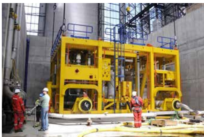
Figure 3. Pompes sous-marines multiphasiques, gisement de CLOV en Angola
